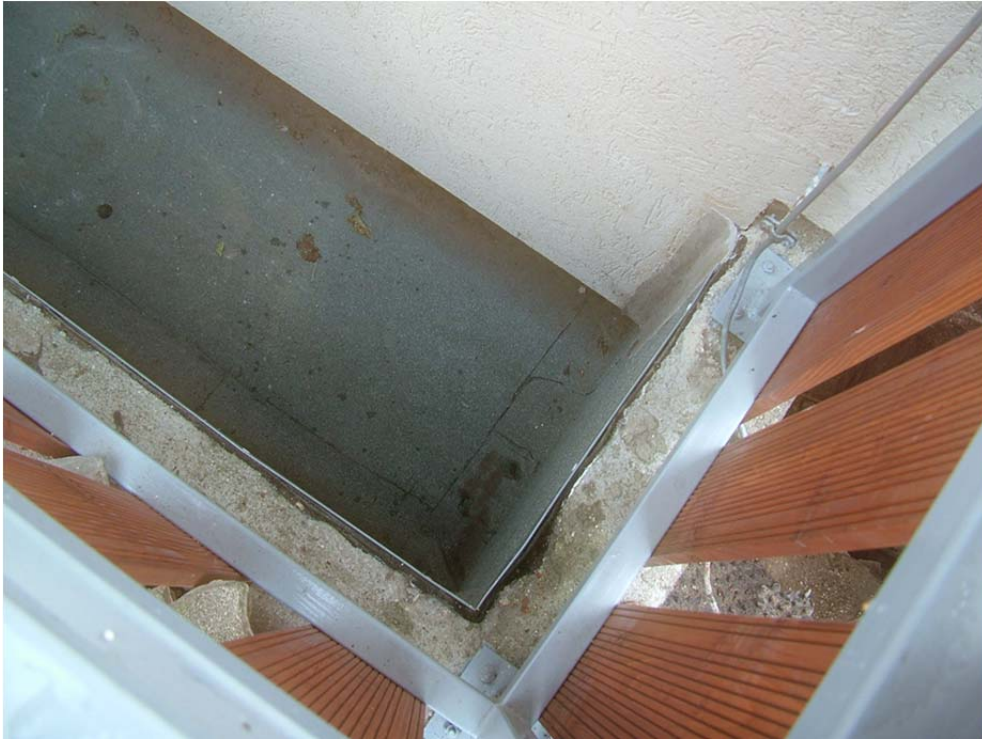
Az angolakna szigetelésének hiányos kialakítása Nincs fedkő, a csapadék bejuthat a szigetelés mögé
