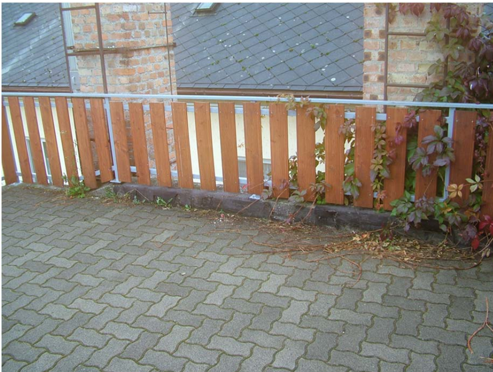
A terasz szegélyének szakszerűtlen kialakítása A bitumenes lemez mechanikai védelem nélkül – meg is sérült már
