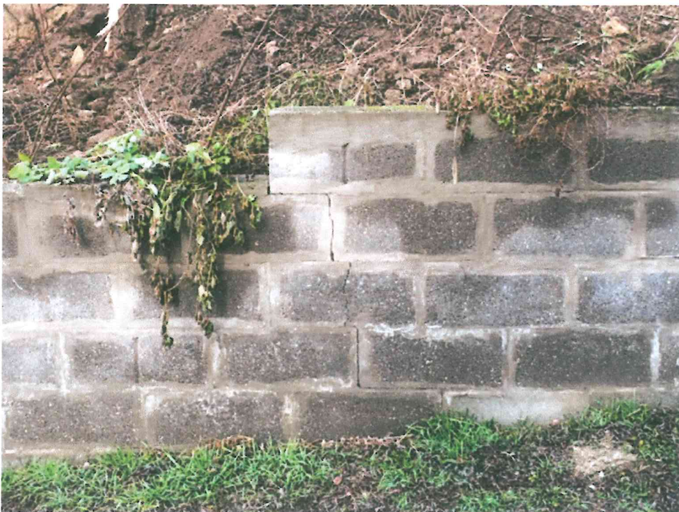
Megdől, repedezett támfal
