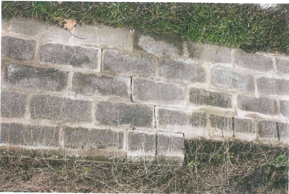
Repedések a támfalon
