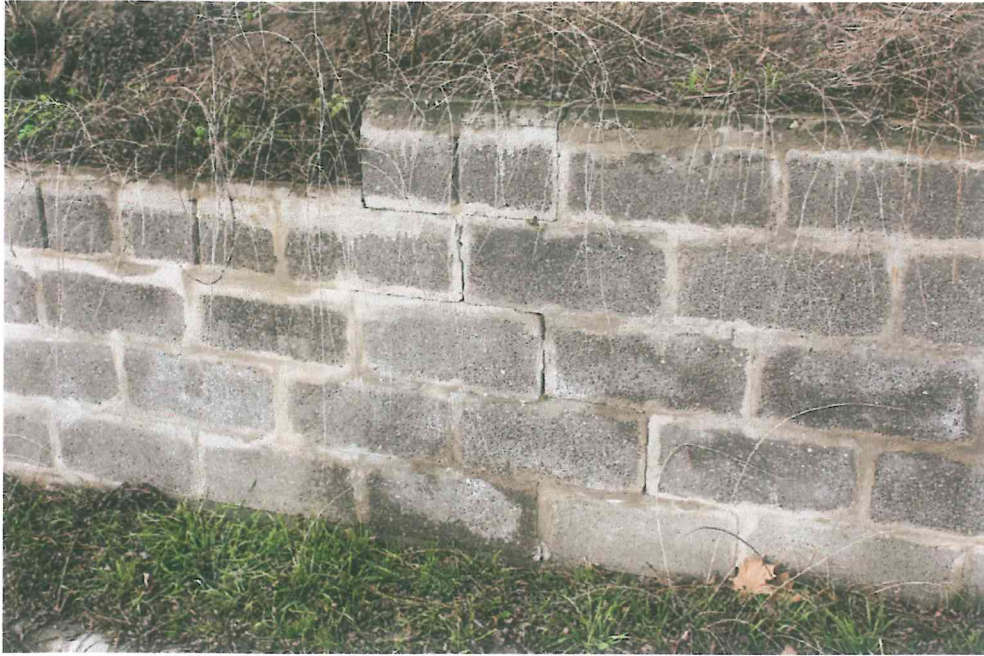
Repedések a támfalon
