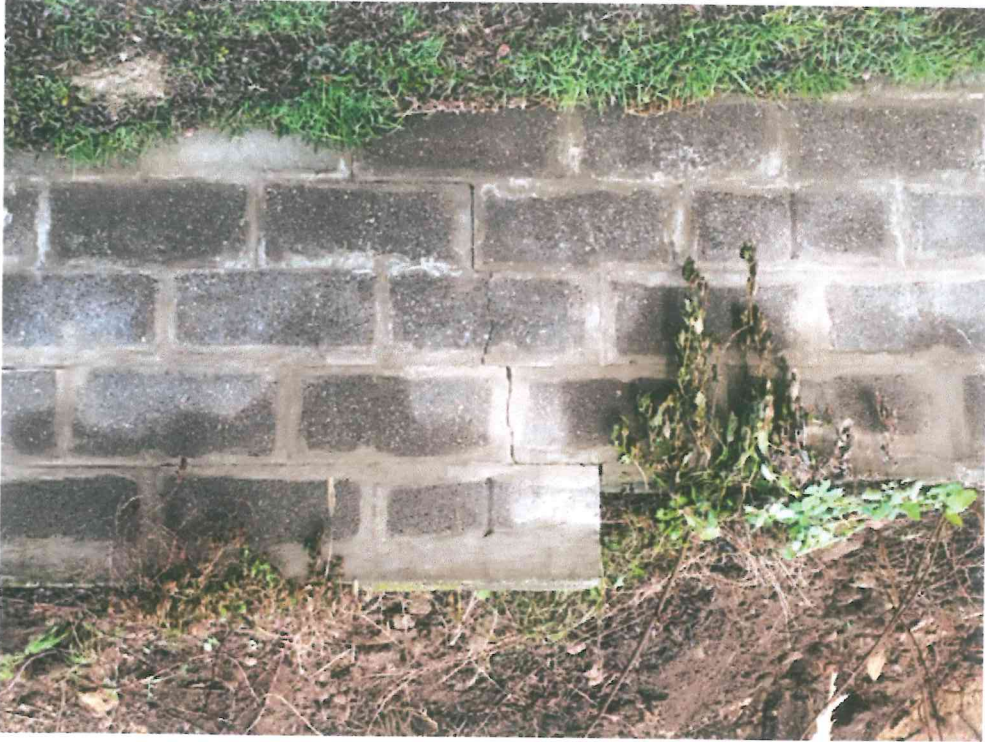
Megdőlt, repedezett támfal
