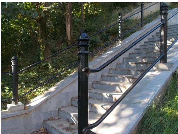
A korlát hegesztése nem megfelelő, korlátelem hiányzik
