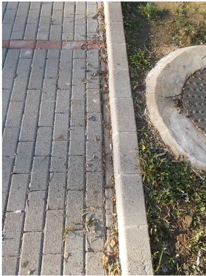
Térkő burkolat megsüllyedt
