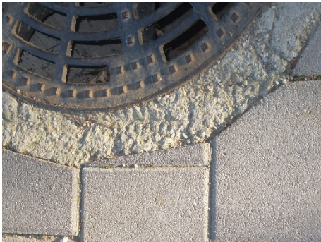
Aknafedlap beton gallérja nem megfelelő
