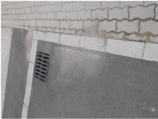
Aszfaltburkolat lejtése nem megfelelő
