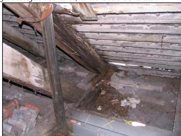
C4 kép. Tipikus egész kastélyra jellemző kép: beázás, komoly károsodás a tetőáttörésnél,
