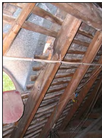
A2 kép. A Cseréptörésből adódó beázás, károsodás
