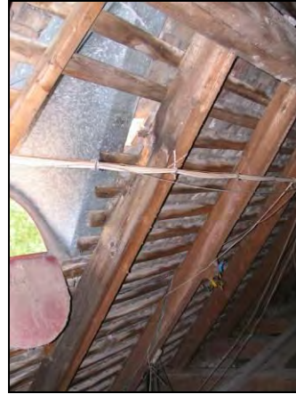
A2 kép. A Cseréptörésből adódó beázás, károsodás
