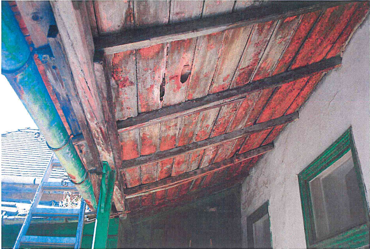
A terasz károsodott tetőszerkezetének részlete
