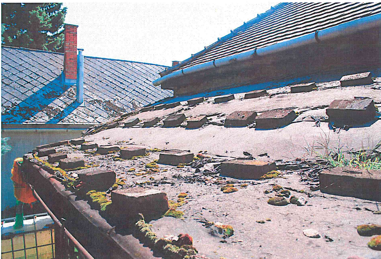
A zárt veranda jelenlegi tört síkú tetőszerkezete az utólagos letakarásokkal
