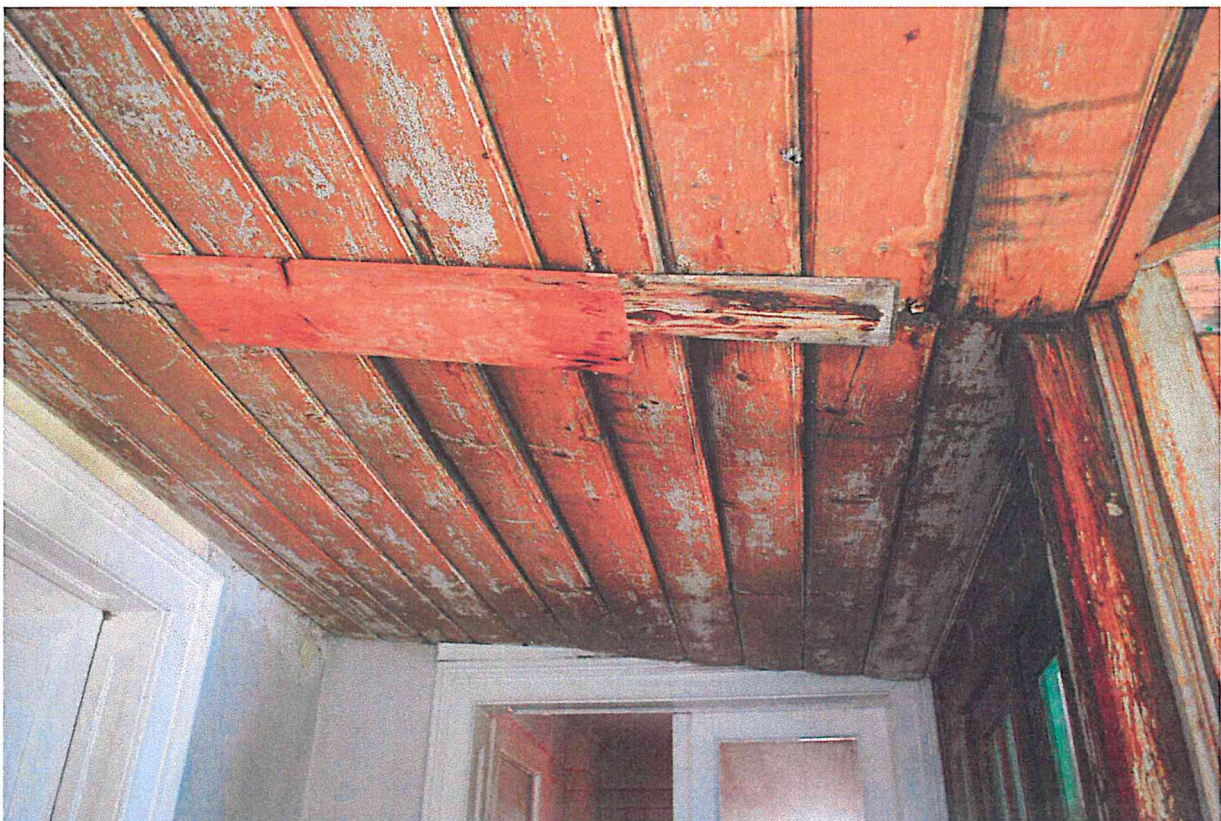
A veranda károsodott belső lambéria burkolata a ház csuklópontjában
