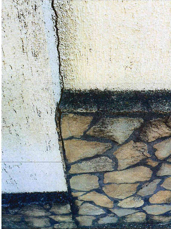
Lakóház utcafront felőli lábazat állapotfotó 2:
