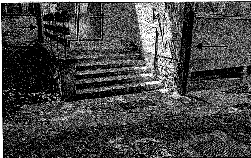
12. számú kép. Hátsó homlokzat, oldalsó épülettömb. A csapadékvíz a lapostetőről ereszcatornába folyik, onnan jönnek le a lefolyócsatornák, lásd kék nyíllal jelölve. A vízvezetés nem megfelelően működik - lásd mindkét esetben a vakolat károsodásokat és a mohásodásokat, melyek a csapadékvíz állandó jelenlétére utalnak.
